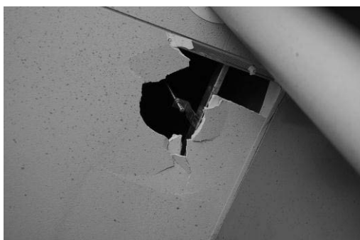
写真3 破損したベランダの天井
