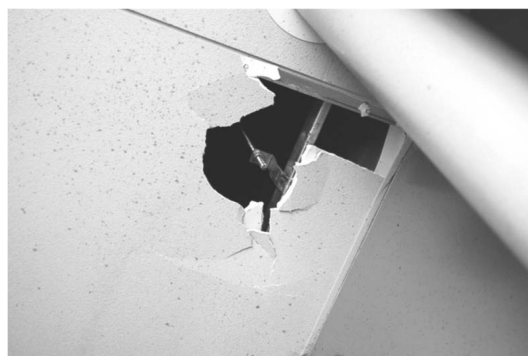
写真 3 破損したベランダの天井
