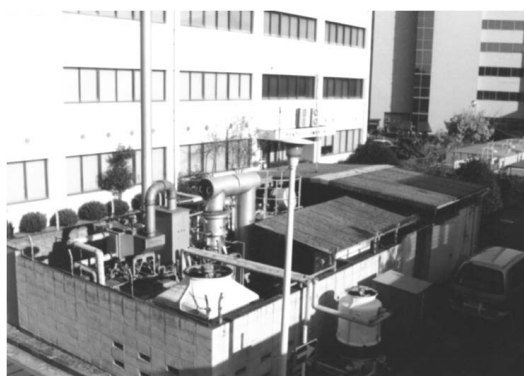
運用時の有機廃液焼却施設
