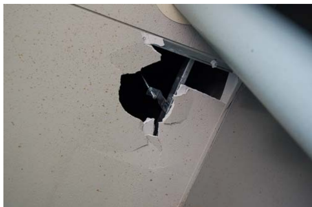
（写真2）破損したベランダの天井
